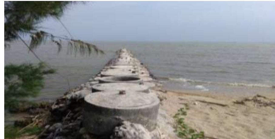
Salah satu kondisi groin di Pantai Wedung
